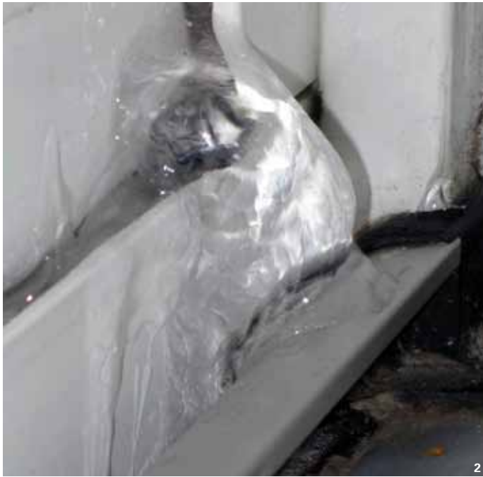
2 Schon kleinste Leckagen können im Extremfall zu Eisbildung führen.
